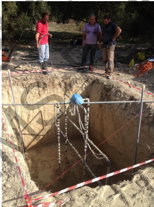
Σχήμα 6: Διαδικασίες πλήρωσης του σκάμματος με εδαφικό υλικό, ευθυγράμμισης της εδαφικής στρώσης και συμπύκνωσής του υλικού με δονητικό μηχάνημα. Μετά την συμπύκνωση η εδαφική στρώση καταβρεχόταν με νερό μέχρι να κορεστεί. Η διαδικασία αυτή επαναλαμβανόταν σε εδαφικές στρώσεις των 20 cm.
